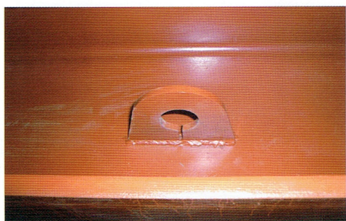
吊フック掛け(2ヶ所有り)
