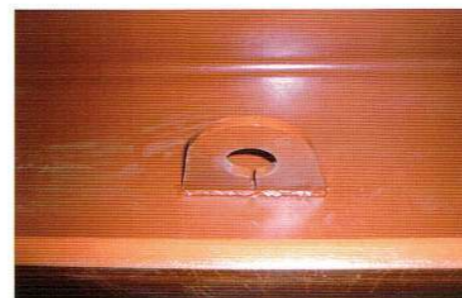
吊フック掛け(2ヶ所有り)
