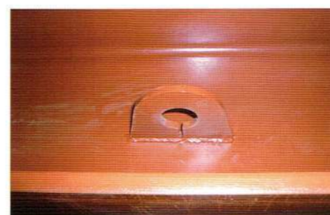
吊フック掛け(2ヶ所有り)
